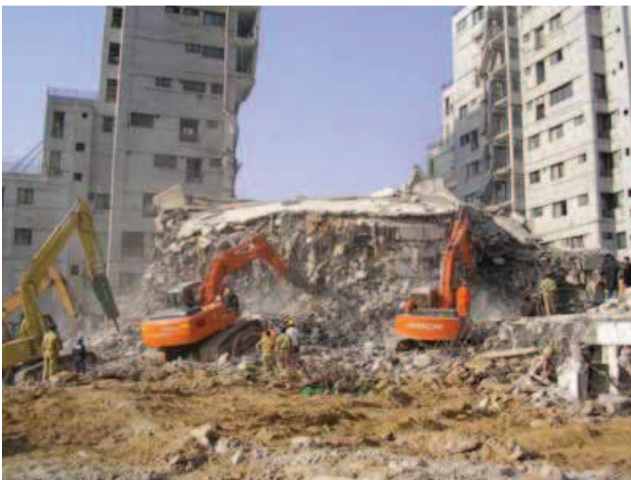
倒壊したマルガラタワー
