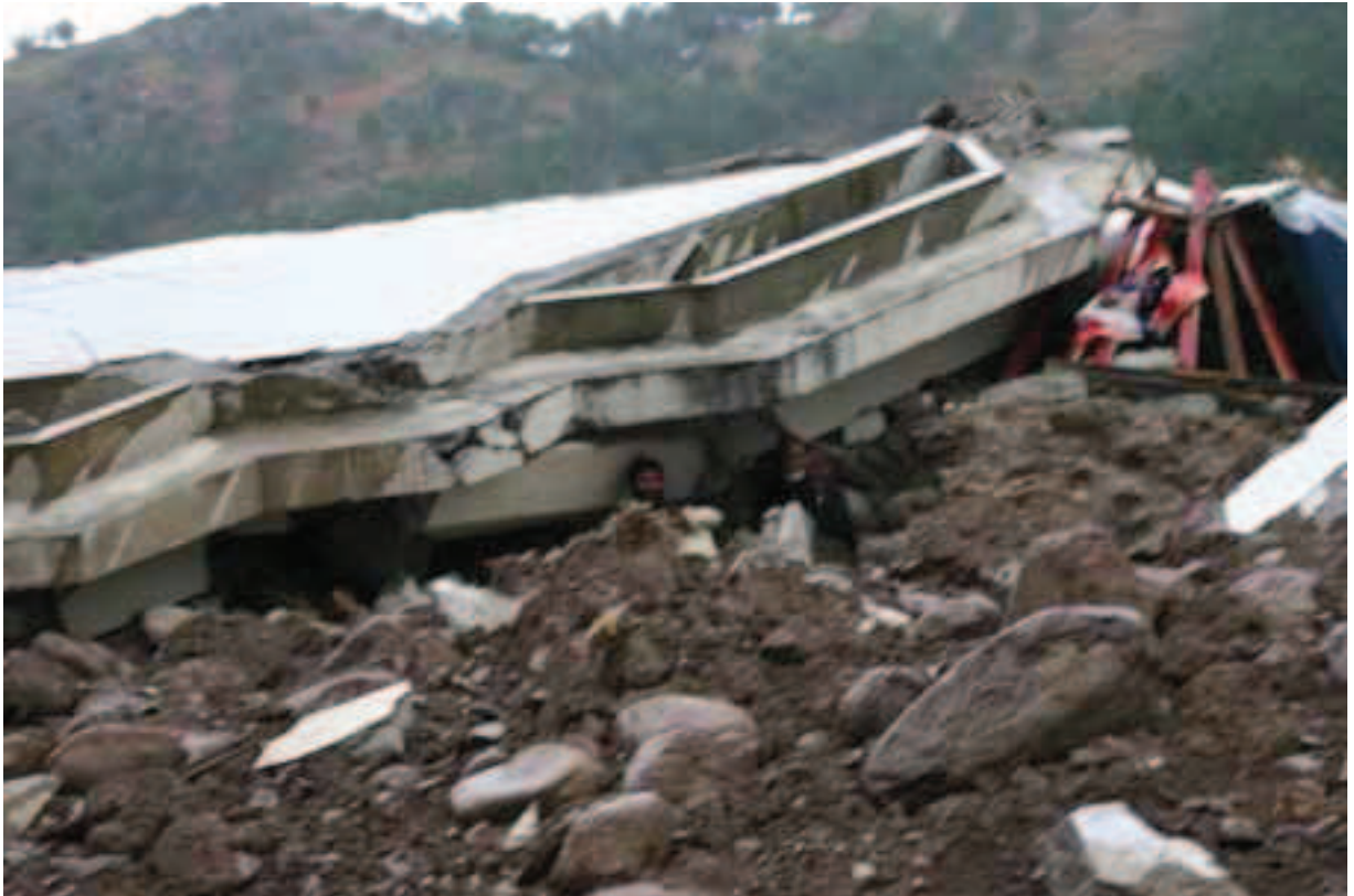
倒壊した建物で雨をしのぐ人たち
